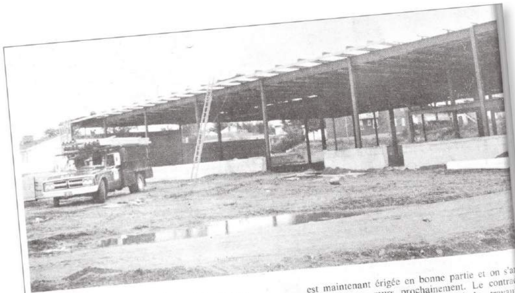
Notre photographe est allé faire un petit tour sur le boulevard Taché, histoire de constater comment allait la construction du futur magasin Coop. Tout semble aller à merveille. La structure
